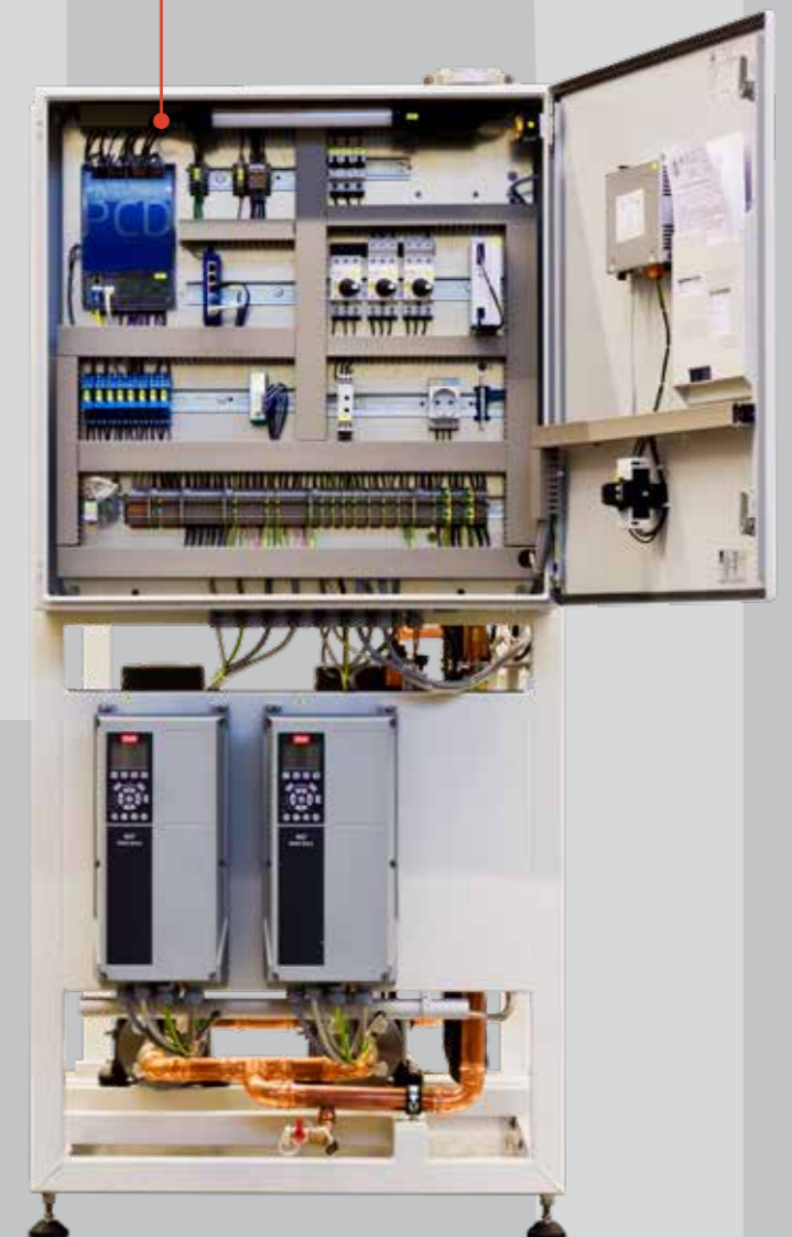
Abb. rechts: Redundante Hydraulikstation etaHydro mit Frequenzumformern und Saia-DDC (Projekt Agaplesion ev. KH, Gießen)
